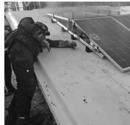
▲ Brandtest PV-panelen op dakbedekking met AllShield Blue-coating.
